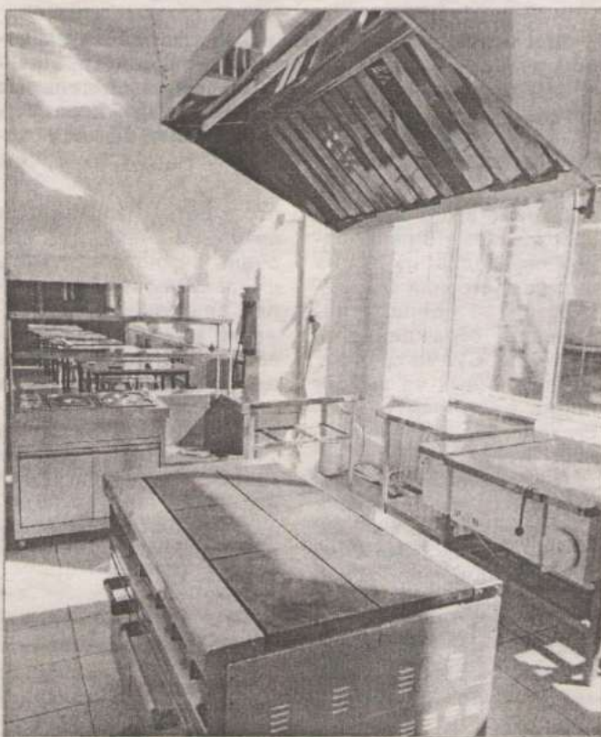
Новый вентиляционный зонт на кухне в НСШ.
